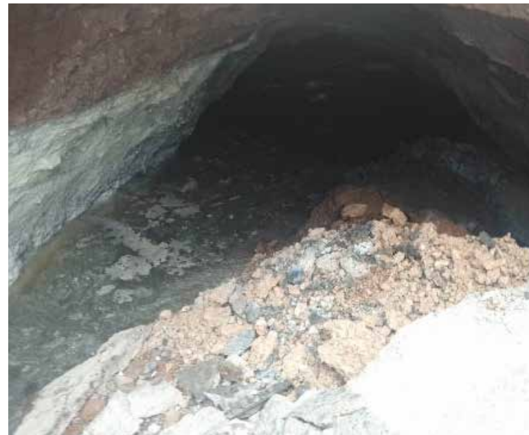
Debido a un colapso en el sistema de drenaje, se ha generado un socavón en esta vía.
