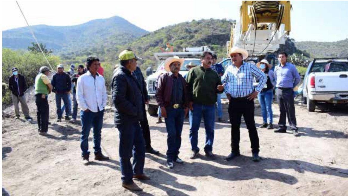
En la Colonia San Antonio, en San Juan Tapa, dio arranque a la perforación del pozo
